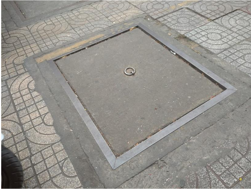
Hình 3.2. Hồ ga đầu nối vào hệ thống thoát nước mưa của thành phố.
